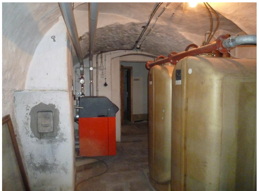
Rauchküche EG mit Tankeinbauten und Heizung
