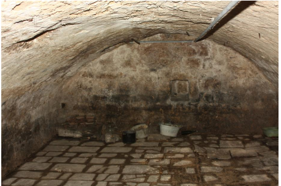
Gewölbekeller im Überflutungsbereich der Altmühl
